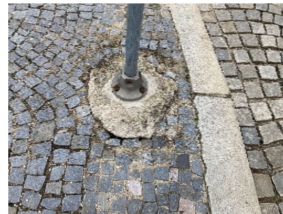
Příklad nevhodného osazení dopravní značky do kamenné dlažby. [ centrum města ]
