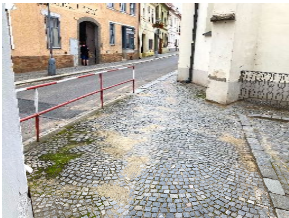
Kombinace nevhodných materiálů v těsné blízkosti centra, nekvalitní provedení, nevhod. provedení oprav. [ ul. Komenského ]
