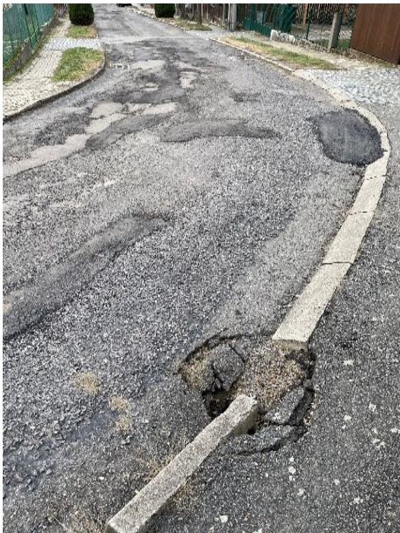
Propadlá část komunikace c celkově velmi špatném technickém stavu. [ ul. Ve Vilách ]
