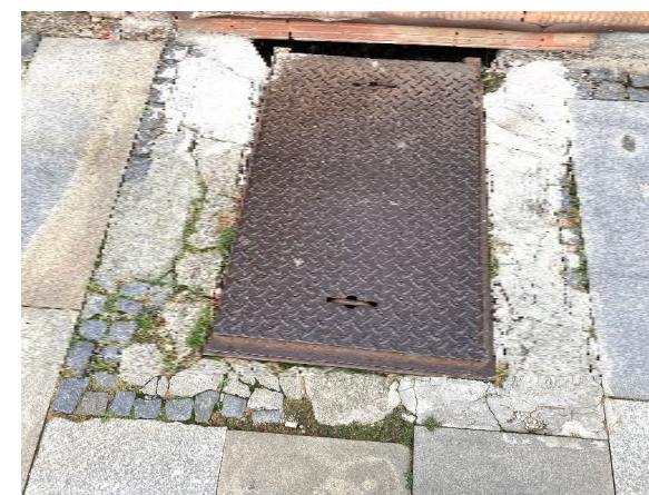
Nevhodná oprava odlišným materiálem. Absence kontroly ke zjednání nápravy. [ Historické centrum města ]
