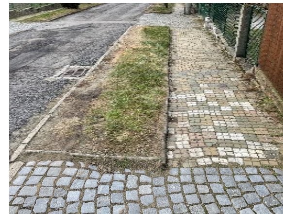
Stav chodníku, kdy je již zdraví nebezpečný. [ ul. Ve Vilách ]
