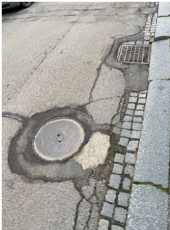
Příklad nevhodného zásahu do asfaltu. [ Historické centrum města ]
