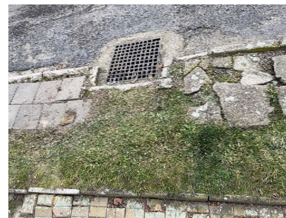
Současný stav některých chodníků a komunikací. [ ulice Ve Vilách ]
