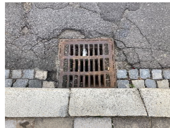
Propadlý kanál ve vozovce. [ centrum města ]
